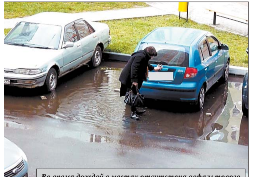
Во время дождей в местах отсутствия асфальтового покрытия образуются своего рода «корыта» с водой.
